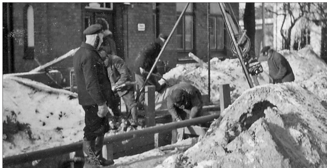
Verlegung der Kanalisation vor dem alten Posthaus 1955 in der Esinger Straße. Foto: Stadtarchiv Tornesch
